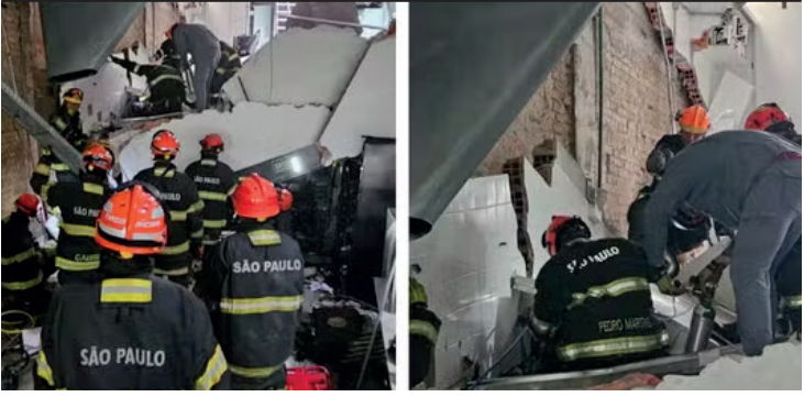
O teto de um restaurante na Bela Vista, região central de São Paulo, desabou nesta quarta-feira (8). — Foto: Montagem/g1/Reprodução/Corpo de Bombeiros
